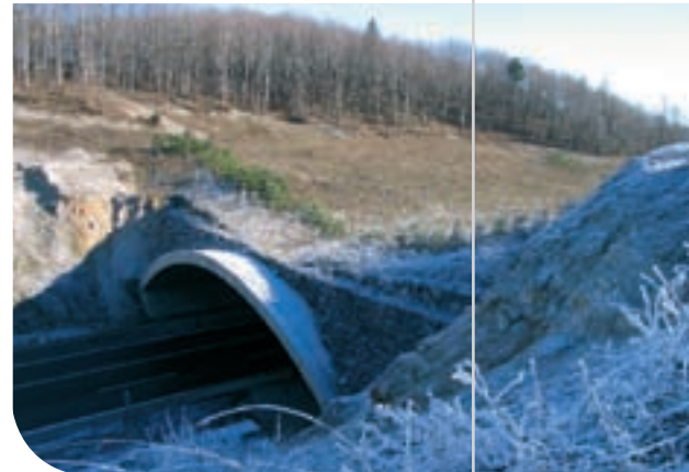
Verbindungen für Naturschutz und biologische Vielfalt sollten ein zentraler Bestandteil der Entwicklung neuer Infrastruktur sein – Grünbrücke in Kroatien. © Arge NATURSCHUTZ
