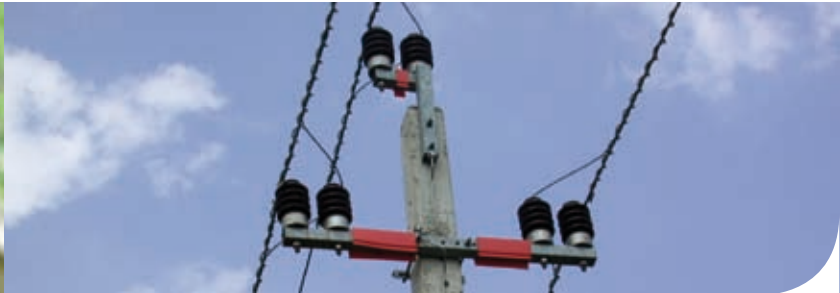
Die ungarische Vereinbarung „Unobstructed Skies“ hat europaweit den Weg für ähnliche Maßnahmen geebnet, um Vögel vor Stromschlägen durch ungesicherte Stromleitungen zu schützen.
